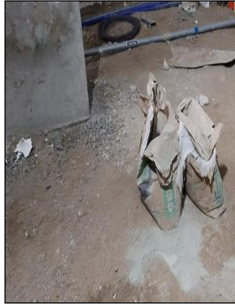
Figura 26 Falta de orden y limpieza
